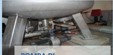
POMPA DI RIGENERAZIONE
